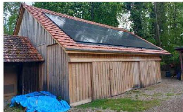
Les travaux de réfection de la toiture du hangar des généiteurs de saumons viennent de se terminer. Photo S.Sp.
